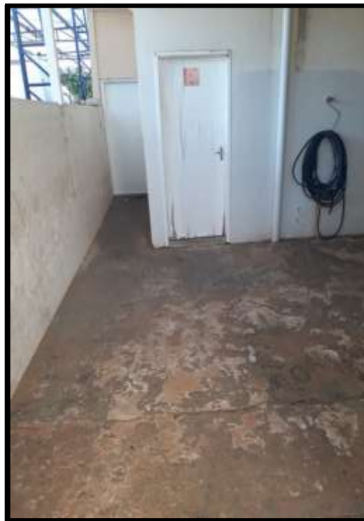
Piso em péssimo estado de conservação
