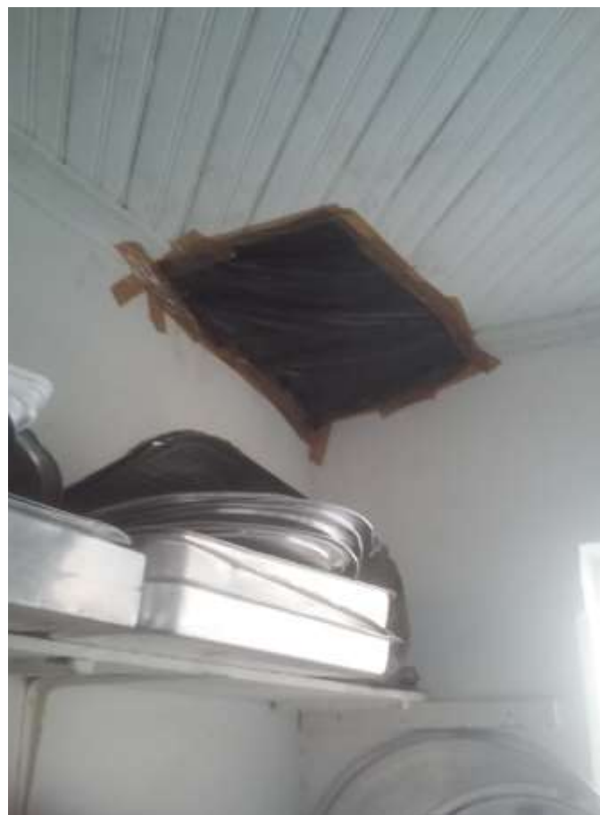
Teto revestido em madeira e em péssimo estado de conservação
