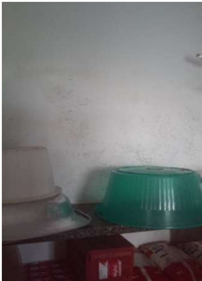
Parede sem revestimento impermeável
