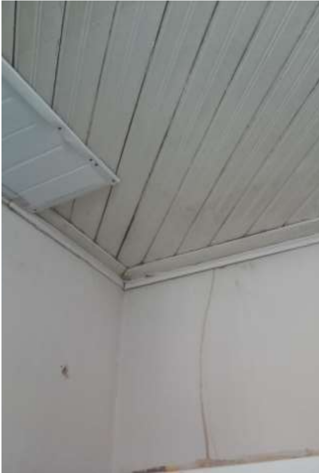
Teto em más condições
