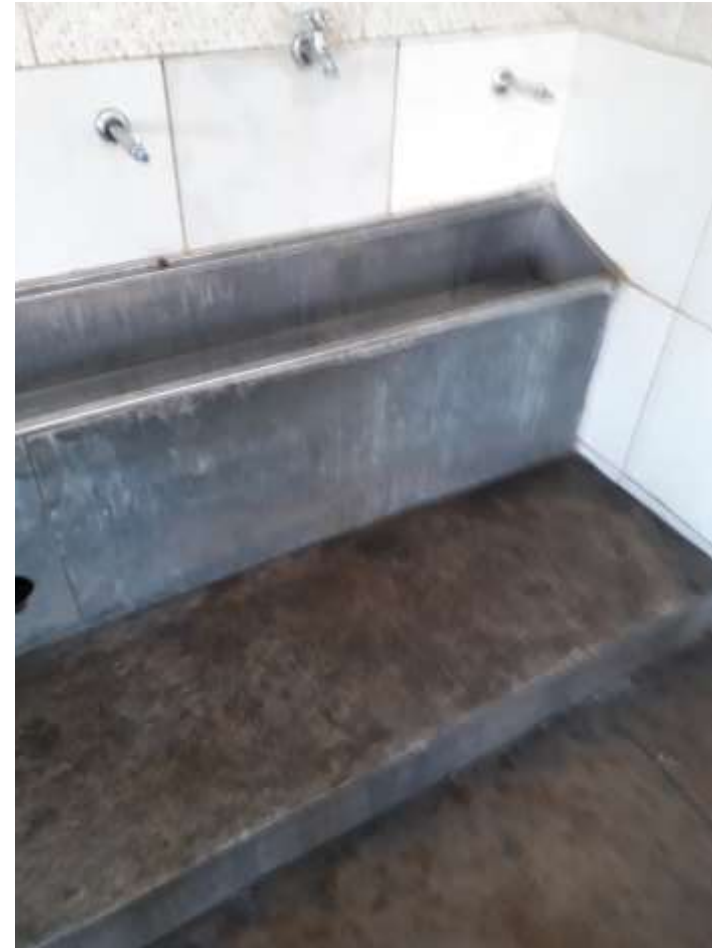
Bebedouro não adaptado e em más condições
