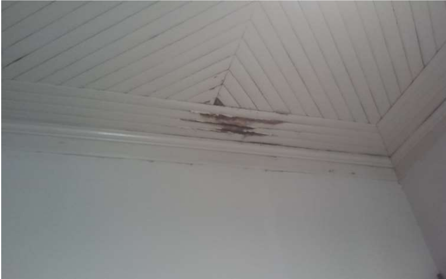
Teto em más condições
