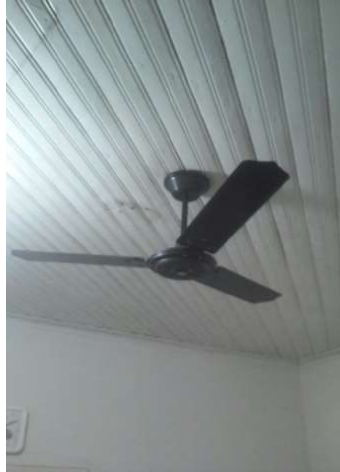
O único ventilador encontra-se quebrado
