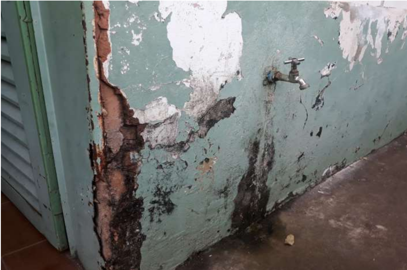
Paredes em más condições
