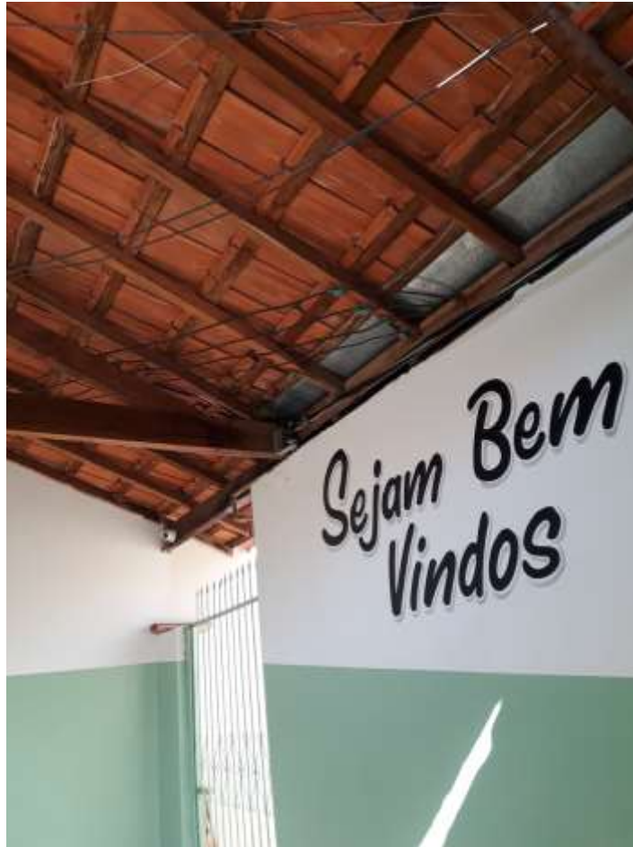
Fiações elétricas expostas
