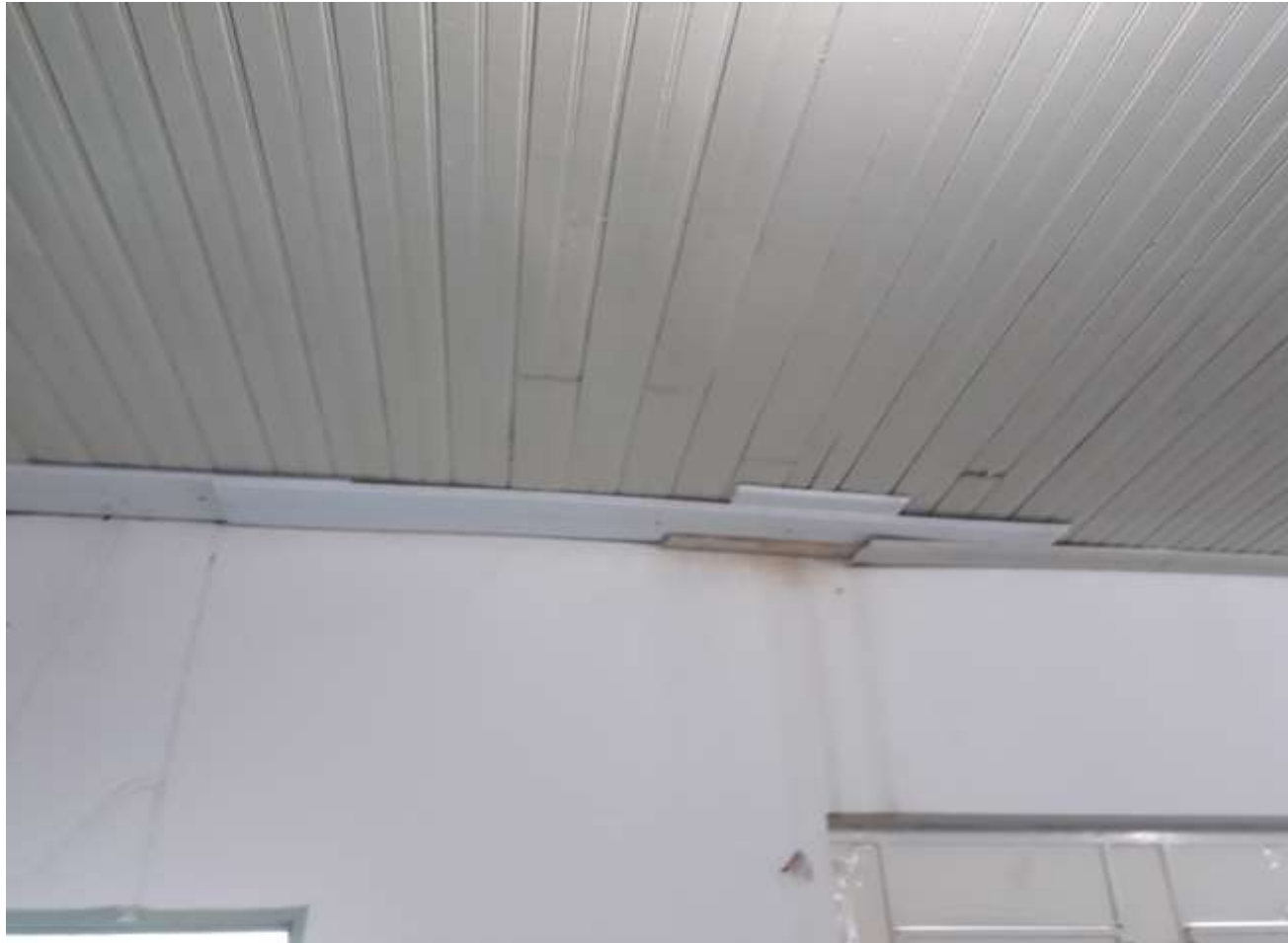
Teto em más condições
