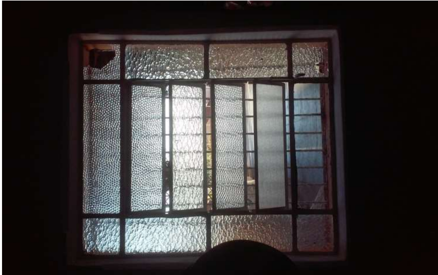
Janela sem tela e com vidro quebrado
