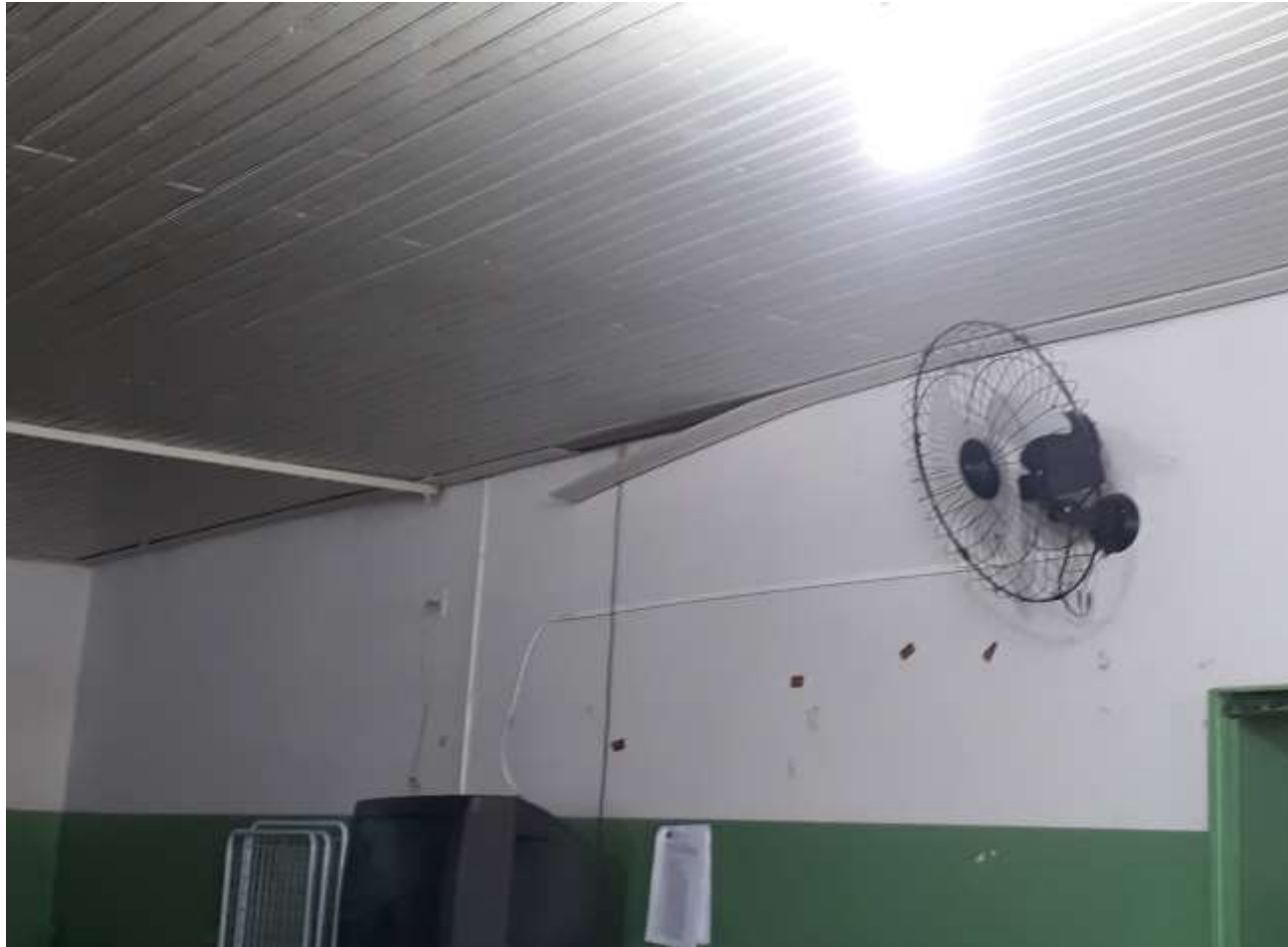
Teto em más condições
