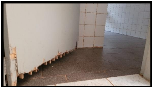
CEMEI Ena Peixoto Junqueira – Porta do banheiro danificada.
