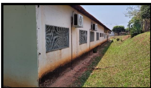
CEMEI Ena Peixoto Junqueira – Parede externa má conservada.
