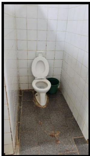
CEMEI Ena Peixoto Junqueira – Piso do banheiro ruim e sem portas das cabines sanitárias.
