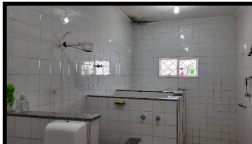
CEMEI Áurea Neves Rodrigues – Teto do banheiro com manchas de bolor.
