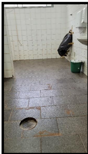
CEMEI Ena Peixoto Junqueira – Ralo no banheiro danificado.
