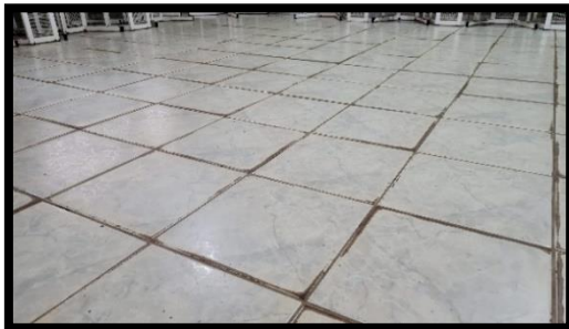
CEMEI Ena Peixoto Junqueira – Pisos das salas desgastados.
