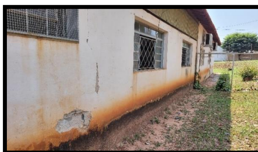
CEMEI Ena Peixoto Junqueira – Parede com buracos e rachadura.
