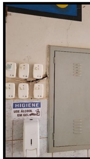
CEMEI Ena Peixoto Junqueira – Fiação exposta na área do refeitório.
