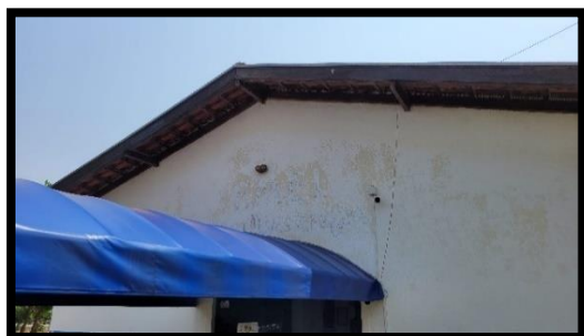
CEMEI Áurea Neves Rodrigues – Sem pintura da fachada.
