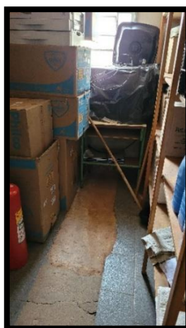
CEMEI Ena Peixoto Junqueira – Depósito de materiais pequeno e com piso danificado.
