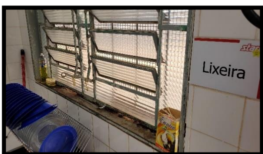
CEMEI Ena Peixoto Junqueira – Janela da cozinha enferrujada.
