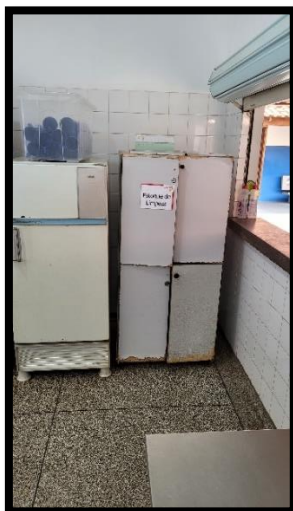
EM Professor José Agreli – Armário de produtos de limpeza danificado.
