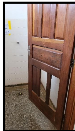
EM Professor José Agreli – Porta do banheiro danificada.
