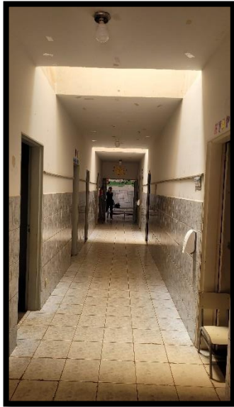
CEMEI Ena Peixoto Junqueira – Corredor central com pisos desgastados.
